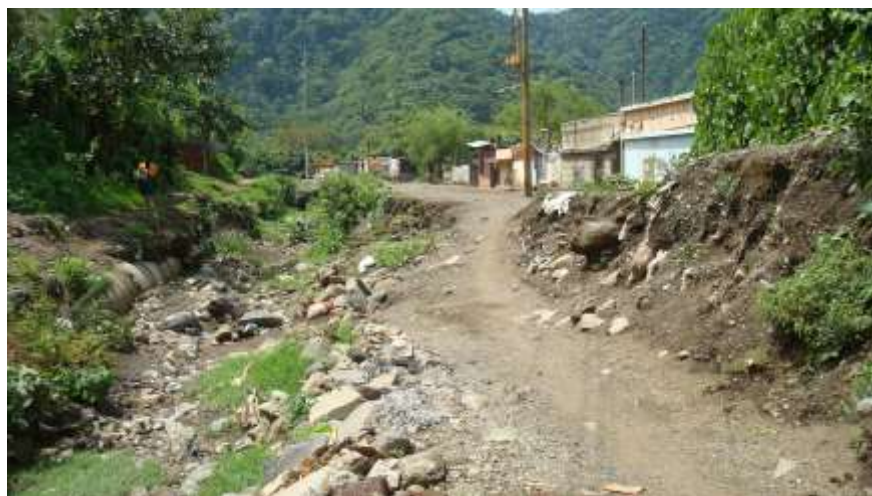
Daños causados por el huracán el 22 de mayo de 2007 en el sector de la Avenida
